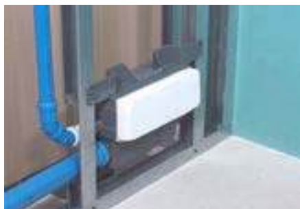
Aplicação em calha técnica
